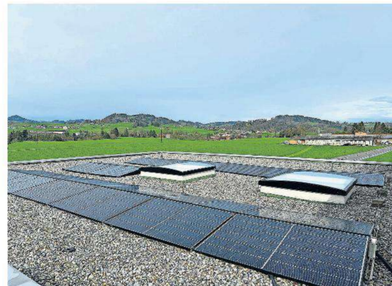
Eine Photovoltaikanlage auf dem Dach soll zukünftig den Energiebedarf sicherstellen.
